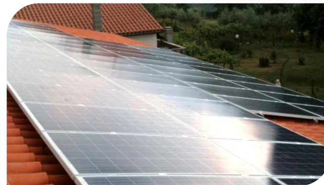
Committente Curia Provinciale Dei Frati Minori Cappuccini Impianto fotovoltaico connesso in rete da 11 kWp, presso Convento Frati Cappuccini di Segni (RM)
