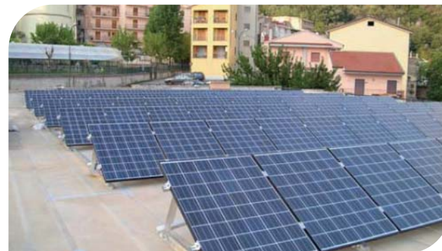
Committente Comune di Olevano sul Tusciano (SA) Impianto fotovoltaico connesso in rete da 20 kWp, presso Scuola Media Garibaldi
