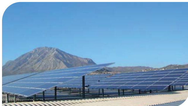
Committente Edilvetro Montesarchio (BN) Impianto fotovoltaico connesso in rete da 68 kWp
