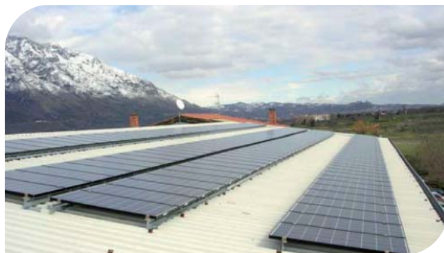
Committente MEC 2000 S.r.l. Airola (BN) Impianto fotovoltaico connesso in rete da 20.25 kWp
