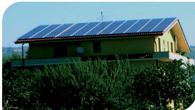
Committente Raffaele Luciano Montesarchio (BN) Impianto fotovoltaico connesso in rete da 17.80 kWp
