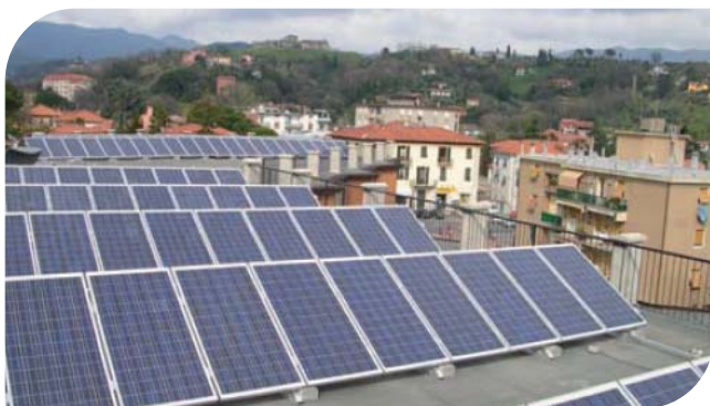
Committente Comune di Sarzana (SP) Impianto fotovoltaico connesso in rete da 20 kWp, presso Scuola media Poggi - Carducci Sarzana (SP)
