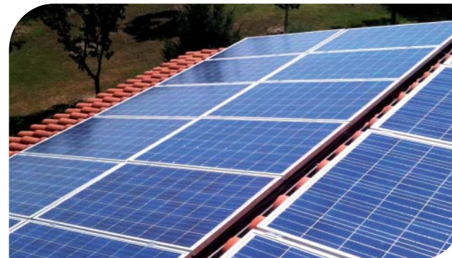
Committente Pignotti Mario Fiumicino (RM) Impianto fotovoltaico connesso in rete da 5 kWp
