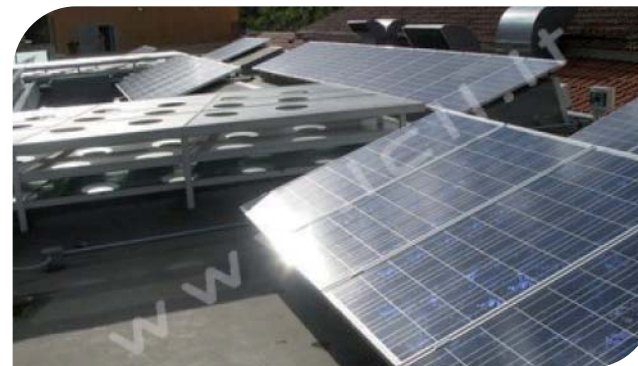
Committente Comune di Roma Impianto fotovoltaico connesso in rete da 30 kWp presso ex Mattatoio lungo Tevere Testaccio (Roma)
