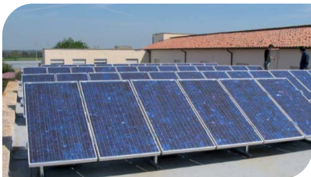
Committente Provincia di Roma Impianto fotovoltaico connesso in rete da 10 kWp, presso Scuola Superiore Paolo Baffi di Fregene (RM)
