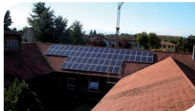
Committente Comune di Cuggiono (MI) Impianto fotovoltaico connesso in rete da 10 kWp, presso Scuola Materna Novara in Cuggiono
